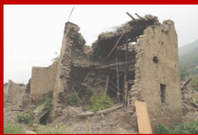
512 的汶川大地震使當地大量在近年建起的石木結構民居損毀倒塌
